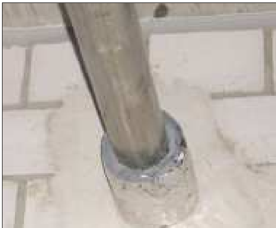
A Unbeschichtete asbesthaltige kaschierte Isolierung im Mauerdurchgang
