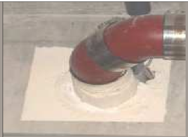
B Mit Brandschutzcoating beschichtete Isolierung
